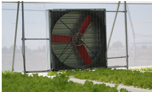
Figura 9: Sistema de ventilación de un invernadero
