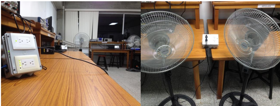
Ilustración 46: Conexiones para pruebas en aula
