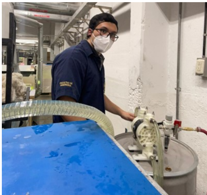
Figura 17: Sistema en funcionamiento
