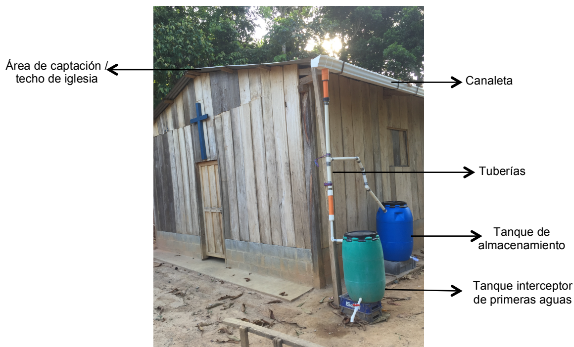
Ilustración 12-Sistema de captación pluvial instalado
