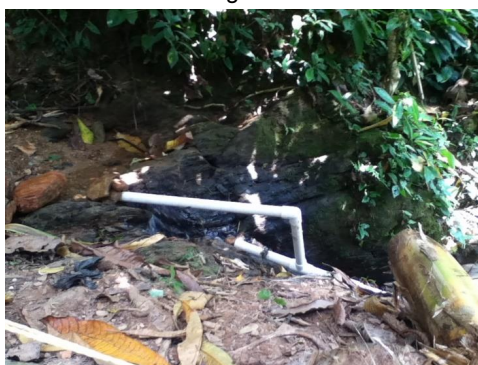
Ilustración 6- Toma de agua del sistema de bombeo
