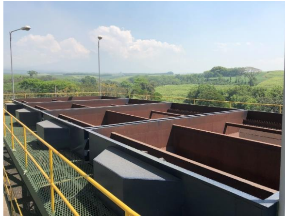
Ilustración 16: Tolvas de decantación
