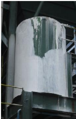
Ilustración 18: Tanques de neutralizadores de pH
