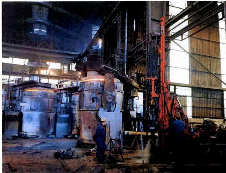
Figura 8. Cimentación de maquinaria
