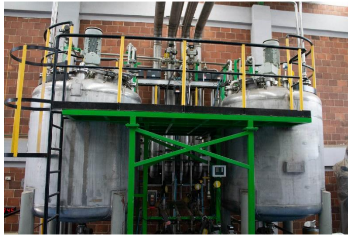
Anexo 3 Tanques de almacenamiento
