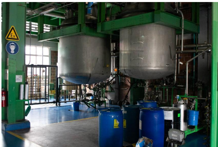
Anexo 7 Tanques de mezcla
