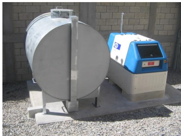
Ilustración 2: Sitio con un motogenerador y su tanque mensual
