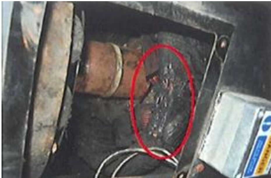
Ilustración 20: Muestra embobinado con punto de falla
