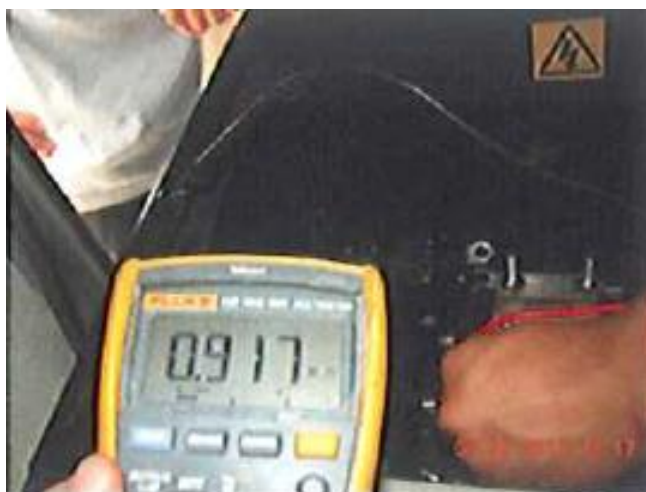
Ilustración 24: Muestra la medición del aislamiento en el motor menor al requerido
