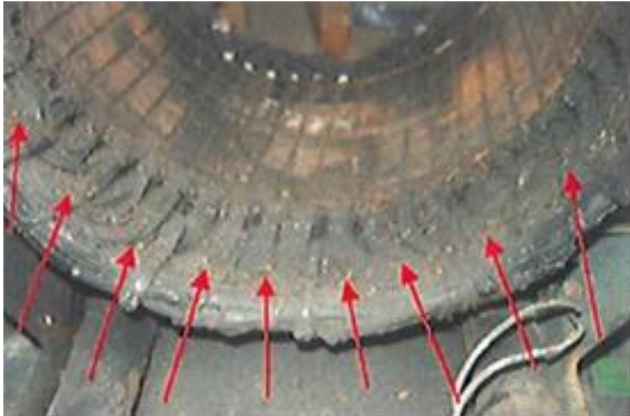
Ilustración 23: Muestra óxido en la parte interna de las bobinas
