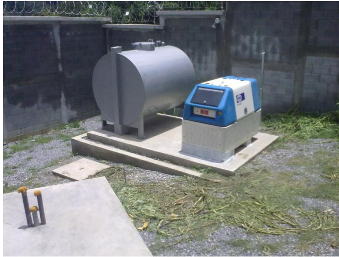
Ilustración 56: Vista de motogenerador y tanque de diesel en su sitio
