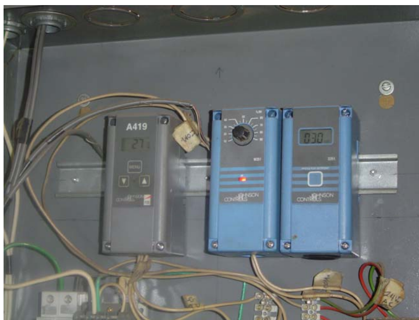
Figura 4. Controladores de humedad relativa y temperatura
