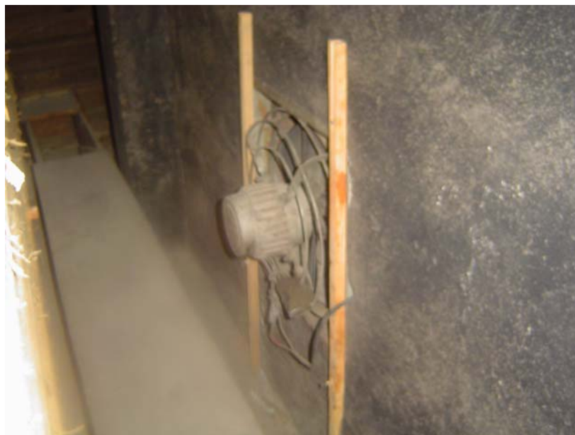
Figura 10. Ventilador extractor de humedad
