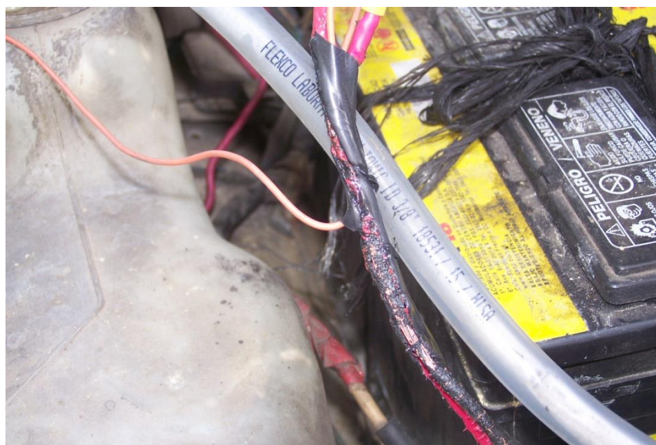
Figura 7.26. Problemas por calentamiento en líneas eléctricas.
