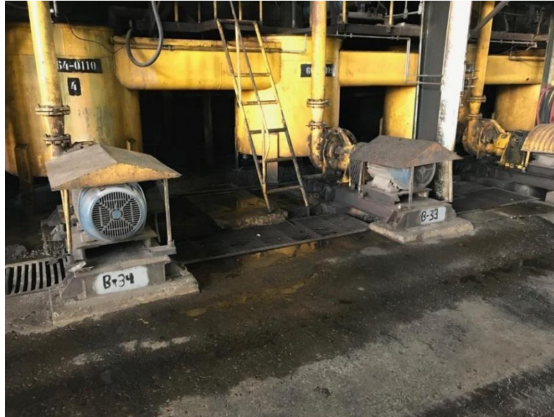
Figura No.136 Bombas de maceración
