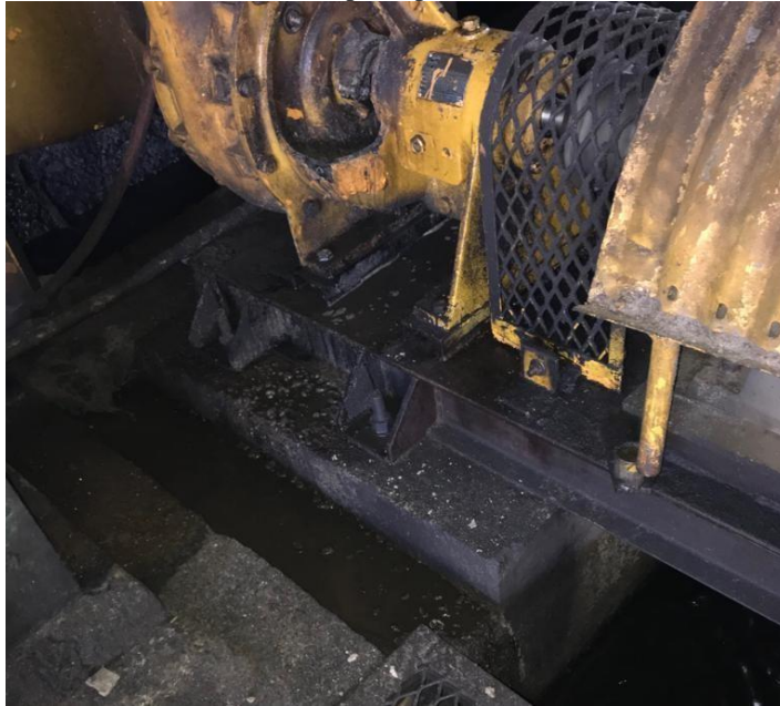
Figura No.138 Filtración de jugo mezclado proveniente de bombas de maceración y desagües a canal principal
