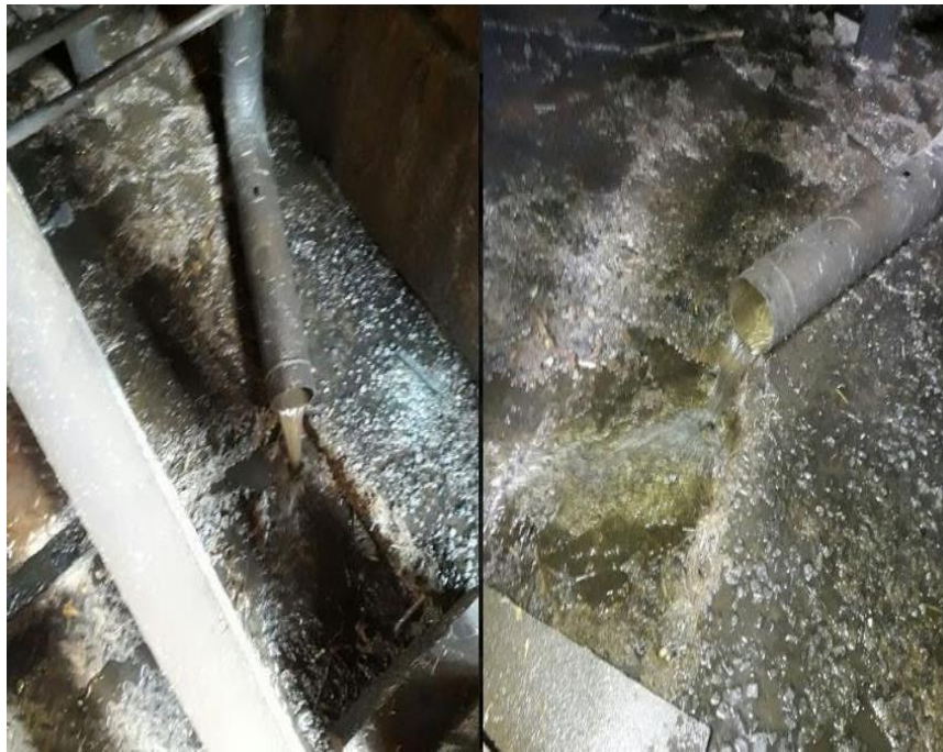
Figura No. 110. Antes y después de tubería agua de enfriamiento molino 1 y 2.
