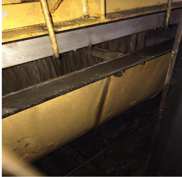
Figura No.140 Filtración de jugo mezclado en separador de bagazo
