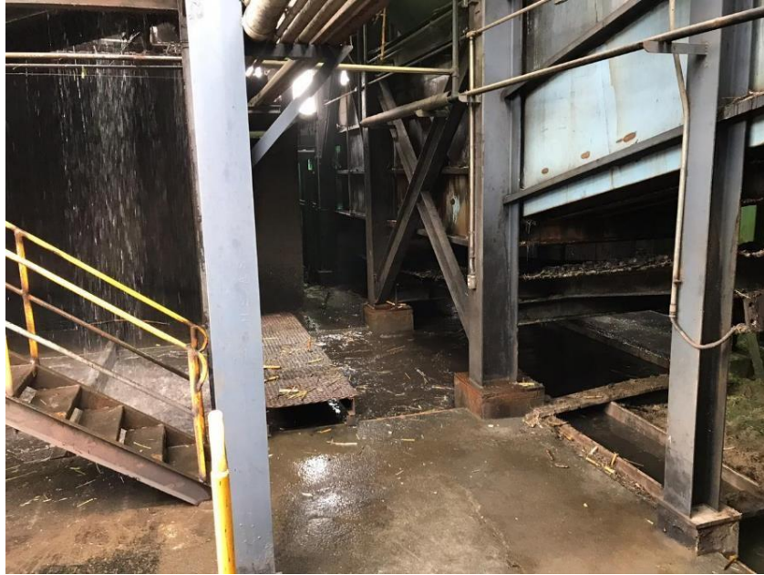
Figura No.142 Conductores de caña en patio de Tándem A
