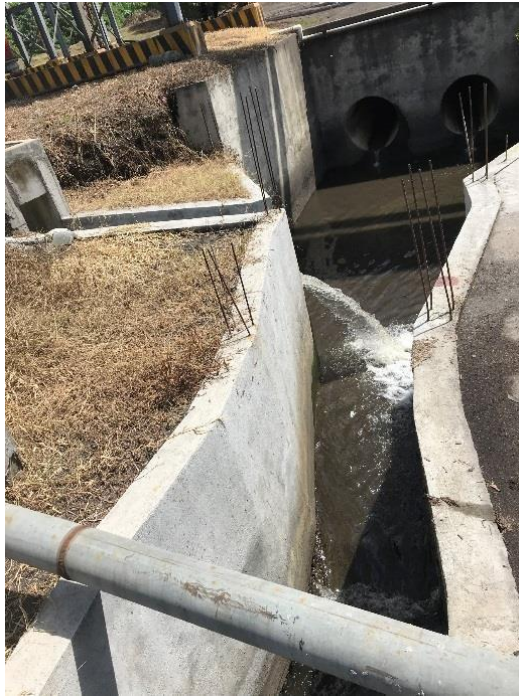
Figura No.22: Canal de Parshall de fábrica del ingenio azucarero
