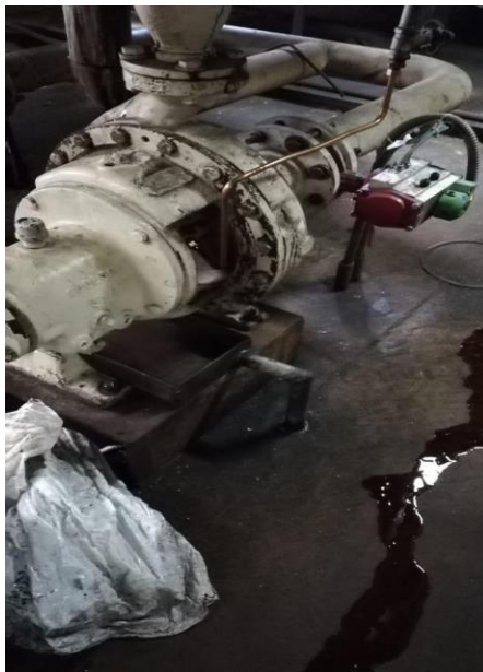
Figura No.104: Bandejas instaladas en la parte baja de cada bomba de licor rubio hacía tanques de tratamiento.
