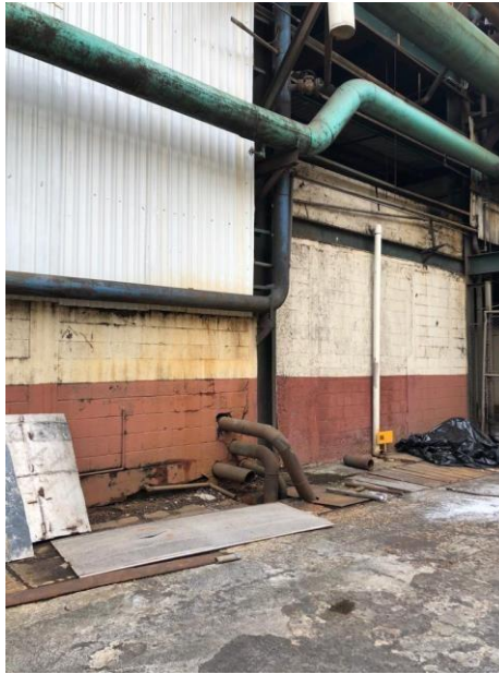
Figura No.103: Salida de tuberías 21, 22, 23 y 24 a canal de efluente principal de fábrica.
