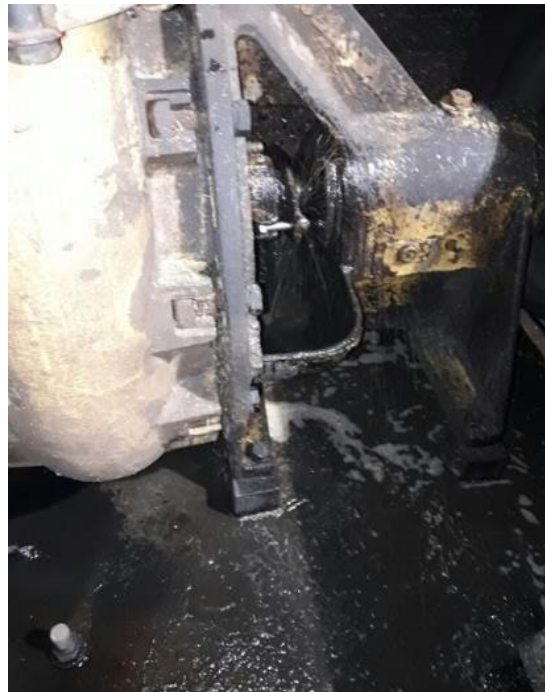
Figura No. 106. Fuga en bomba de jugo de caña (B124)
