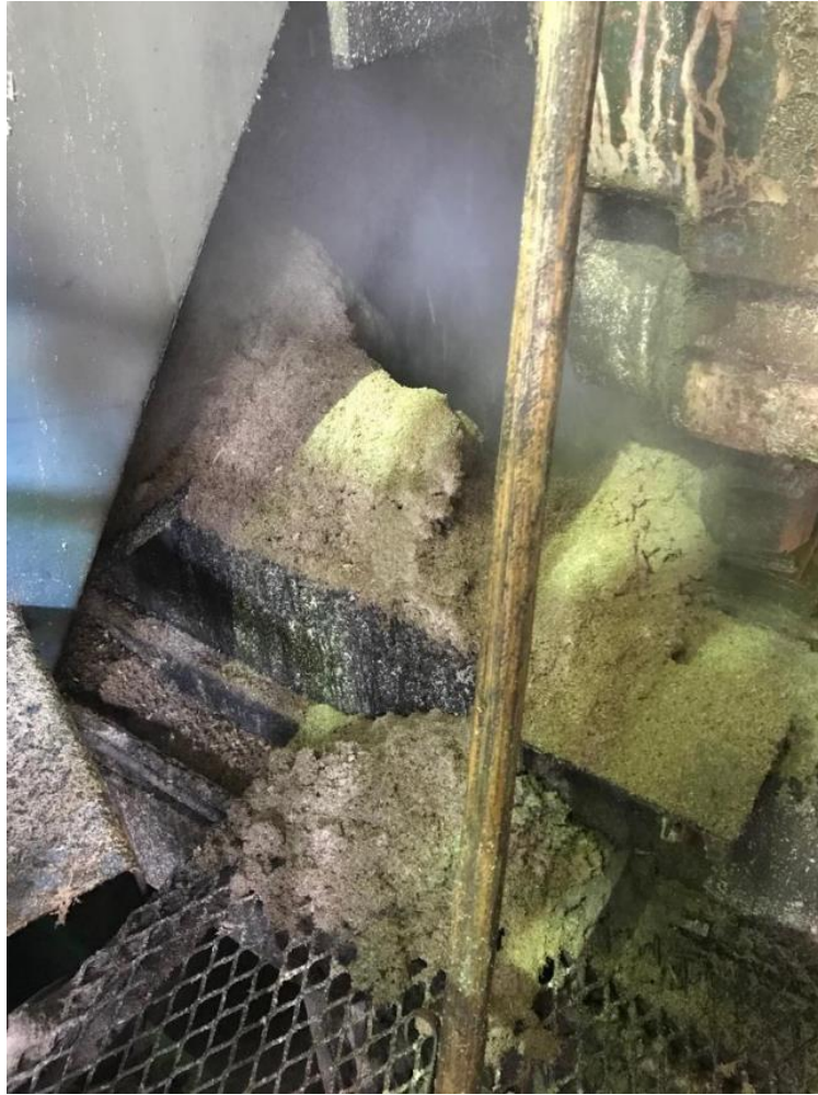
Figura No.144 Filtraciones de bagazo en alimentación a conductores de banda hacia calderas
