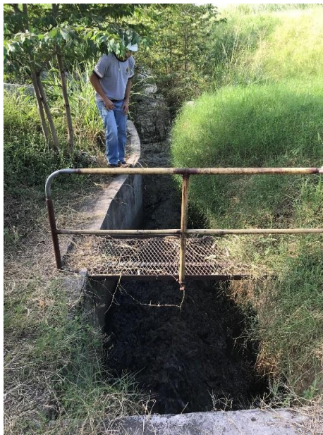
Figura No.23: Canal de Parshall de patio del ingenio azucarero
