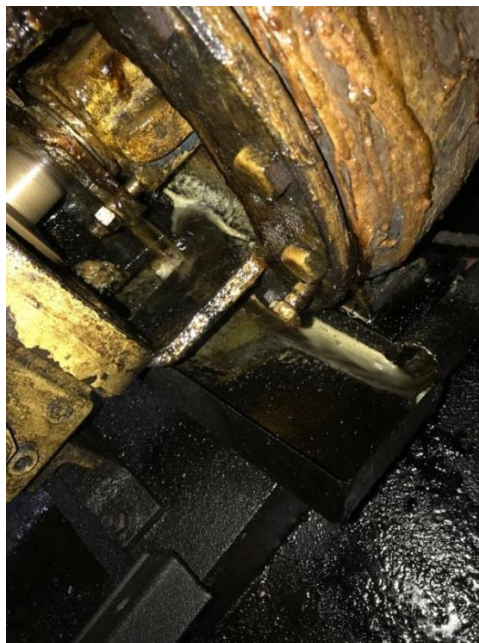
Figura No.139 Filtraciones de jugo mezclado en bombas de maceración
