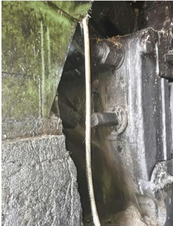
Figura No.109. Fuga entre molino 1 y 2
