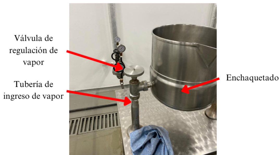
Imagen No.35: Zonas a altas temperaturas de la marmita de vapor
