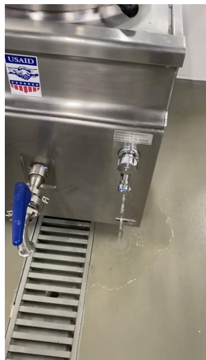
Imagen No.44: Drenado de agua del enchaquetado de la marmita de gas
