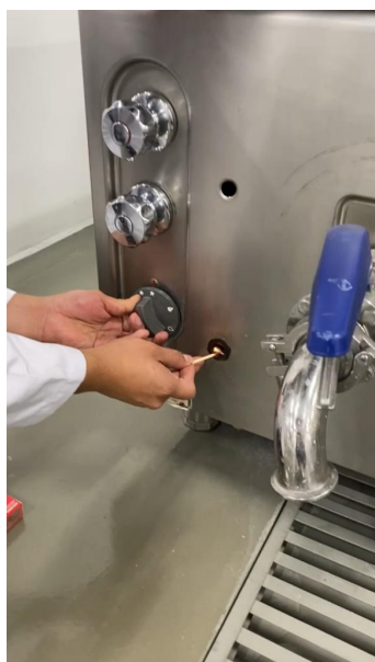
Imagen No.51: Encendido de piloto de la marmita de gas
