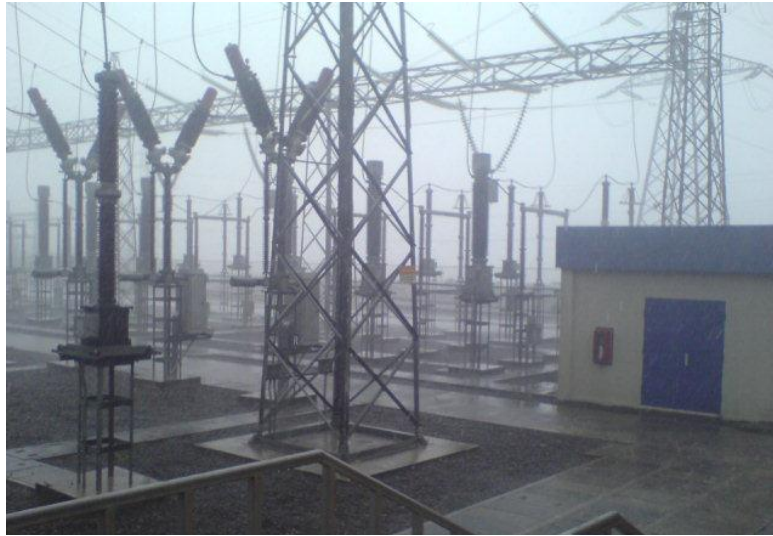
Figura 22. Fotografía de la Subestación Guatemala-Sur.
