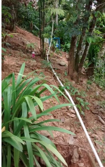
Ilustración 80 Sistema de bombeo enterrado e instalado
