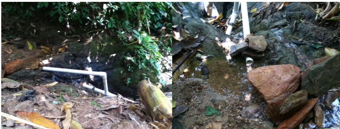
Ilustración 62 – Punto de captación de agua
