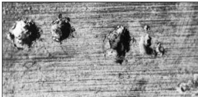
Figura 17. Cráteres en superficie de rodadura.
