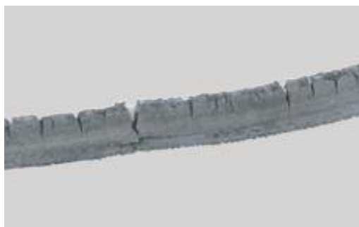
Figura 30. Agrietamiento en banda.
