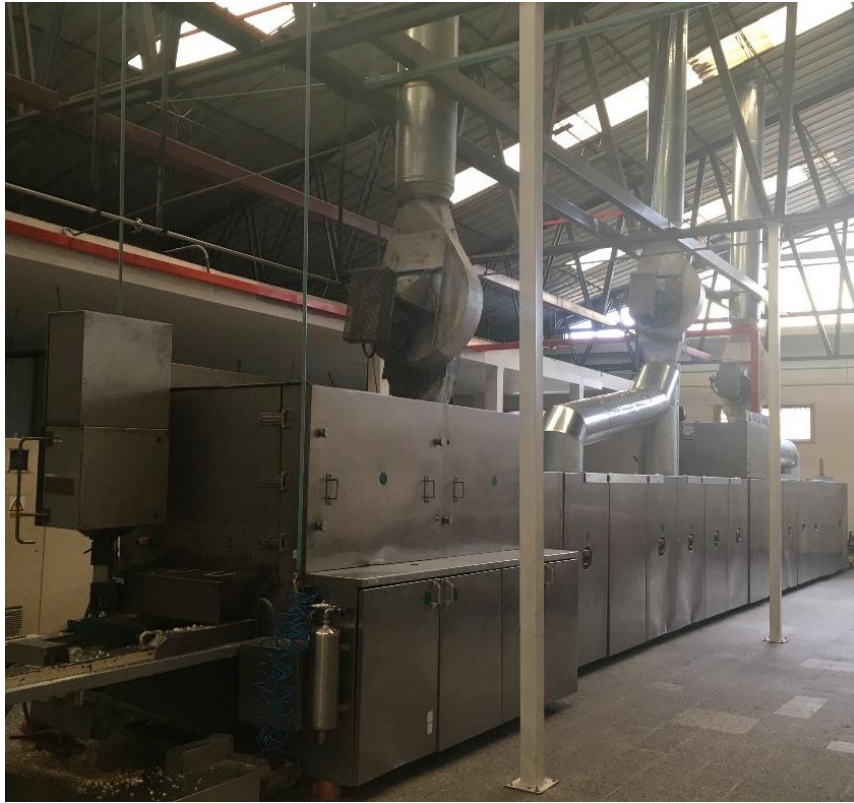
Anexo 6. Horno Hebenstreit de galleta wafer de la línea 3.
