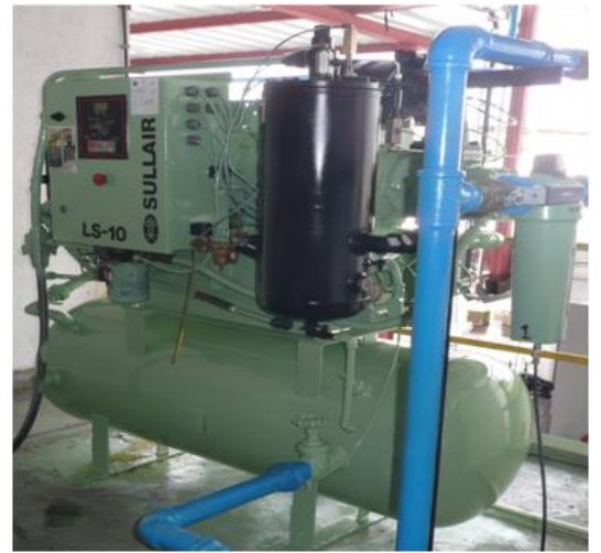
Foto # 2- Compresor Sullair LS0-40L de 40 HP
