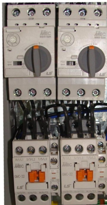
Figura No. 27 Contactores con guarda - motor
