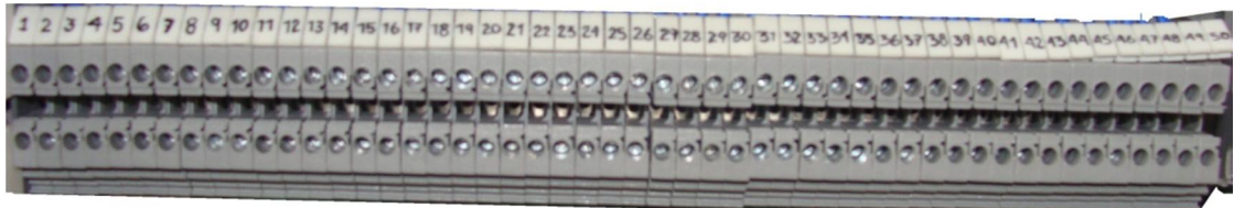
Figura No. 28 Borneras de conexión al proceso
