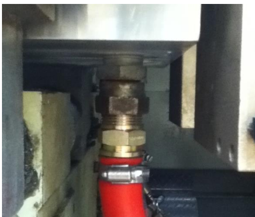
Ilustración 17: Ejemplo de los conectores de agua para las máquinas S-20 y S-21.
