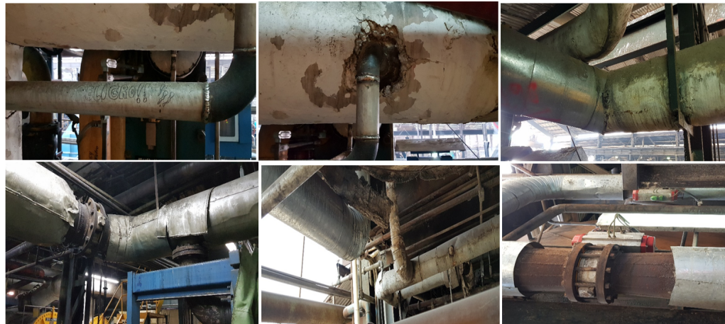
Figura 50. Tuberías con aislamiento en mal estado.
