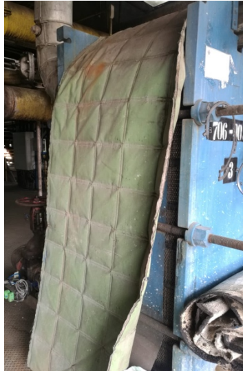
Figura 123. Intercambiador de calor de placas con el aislamiento mal colocado.
