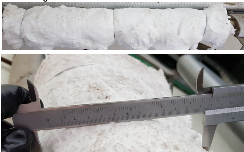
Figura 230. Tubería aislamiento de fibra cerámica.
