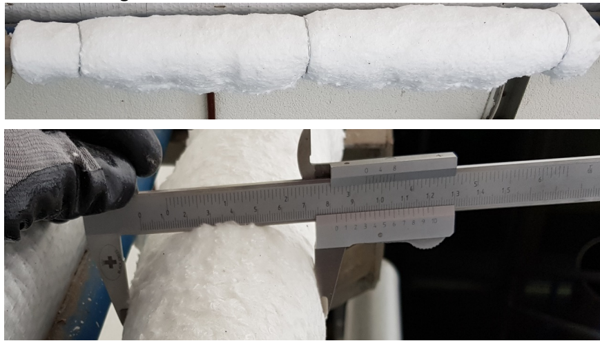
Figura 228. Tubería aislamiento de fibra mineral.
