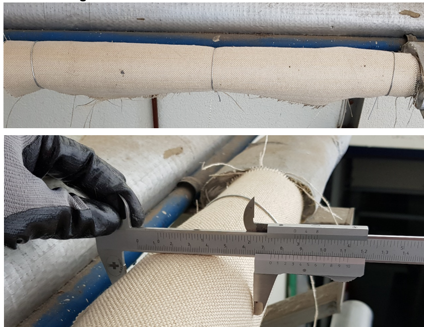
Figura 227. Tubería aislamiento de fibra de vidrio.
