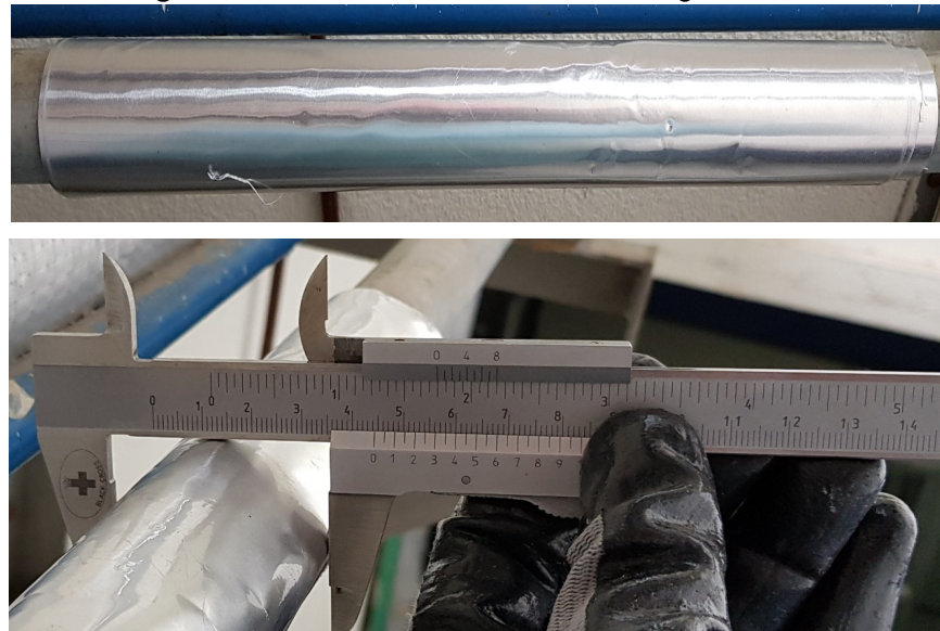
Figura 229. Tubería aislamiento de Lenzing Armacell.
