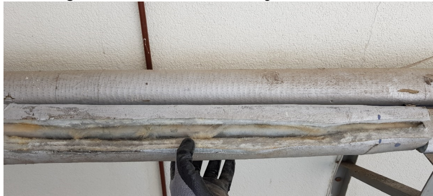
Figura 225. Tubería aislamiento original del laboratorio.
