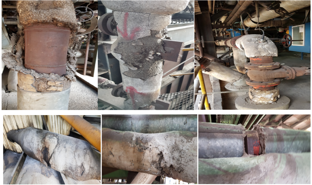
Figura 51. Tuberías con aislamiento cerámico.
