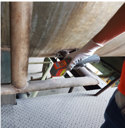
Figura 179. Medición salida de vapor en el intercambiador 9 de concha y tubo de tiempo 13.67 minutos.
