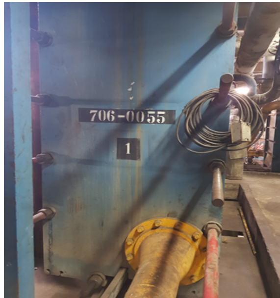
Figura 181. Entrada de jugo del intercambiador de placas 1 con tiempo de 8 min.
