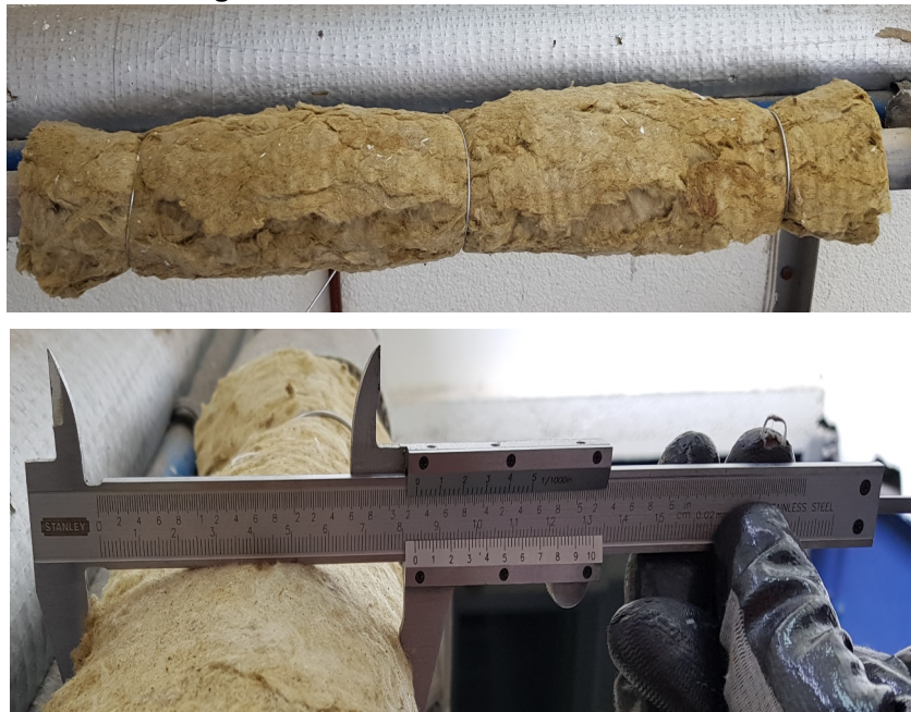
Figura 226. Tubería aislamiento rockwool.
