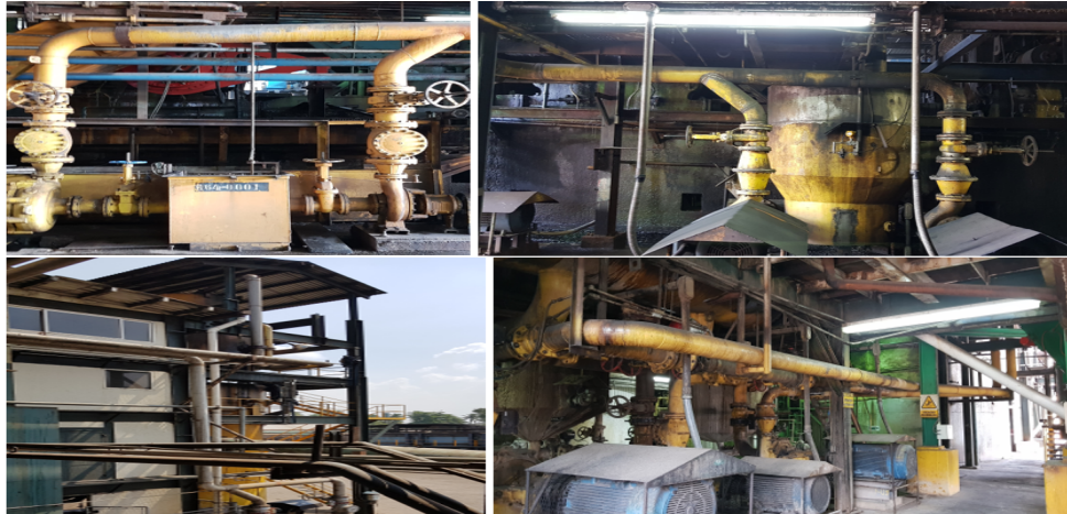
Figura 49. Tramos de tubería que carecen de aislamiento.
