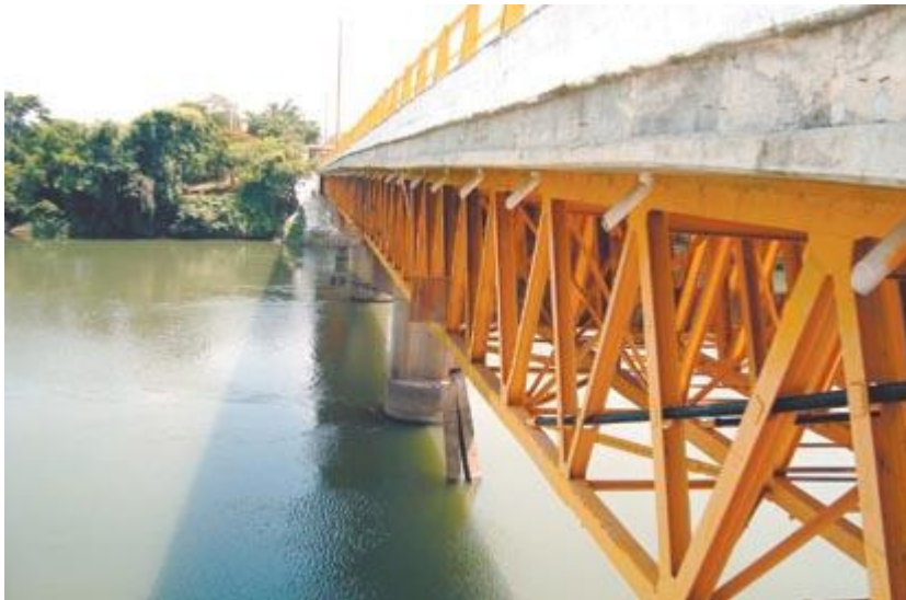
Figura No. 21: postensado externo para el reforzamiento de un puente de armadura
