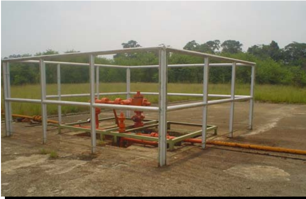
Cabeza de pozo con cerco perimetral
