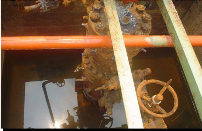
Contrapozo con fluidos
