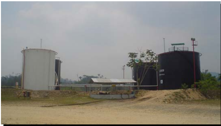
Área de Tanques de Almacenamiento de Crudo
