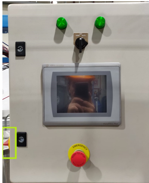
Figura 47: Instalación externa del seleccionador principal.
