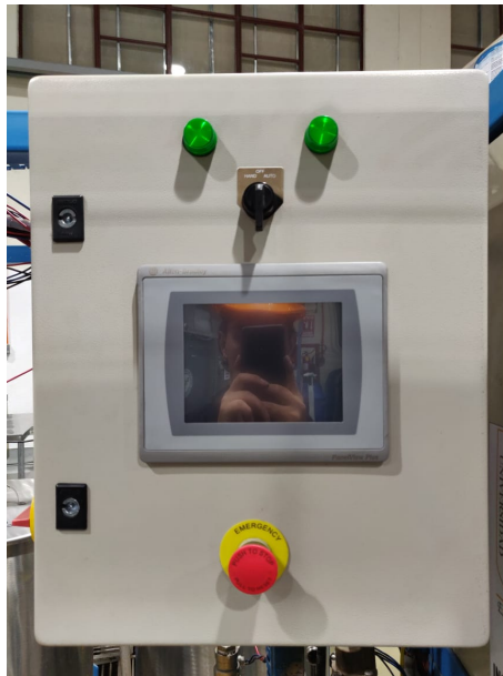
Figura 43: Montaje del panel nuevo con sus respectivos dispositivos instalados (Exterior).
