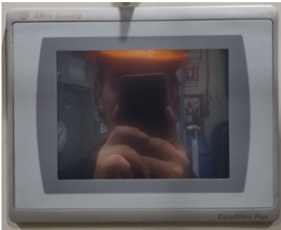
Figura 57: Instalación de la pantalla HMI Touch (exterior).
