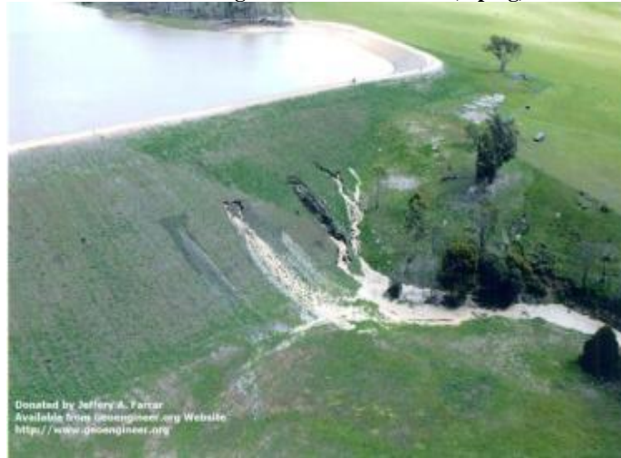
Imagen 14 Erosión interna (Piping)
