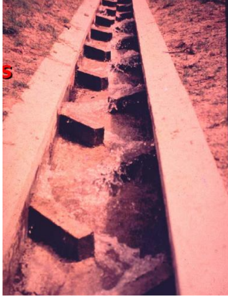
Imagen 29 Canal rápido con disipadores de energía
