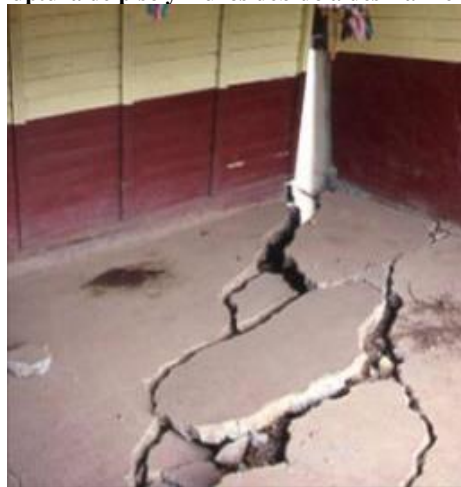
Imagen 20 Ruptura de piso y muros debido a deslizamiento de relleno
