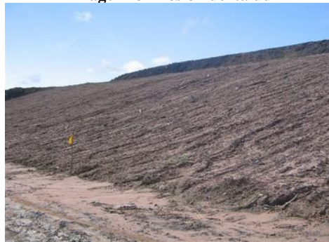
Imagen 23 Erosión del talud
