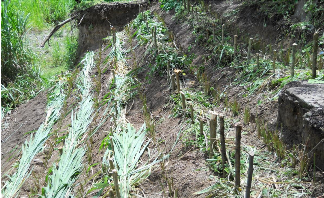
Imagen 81 Talud sembrado de Vetiver y reforzado con restos de vegetación para el control de la erosión
