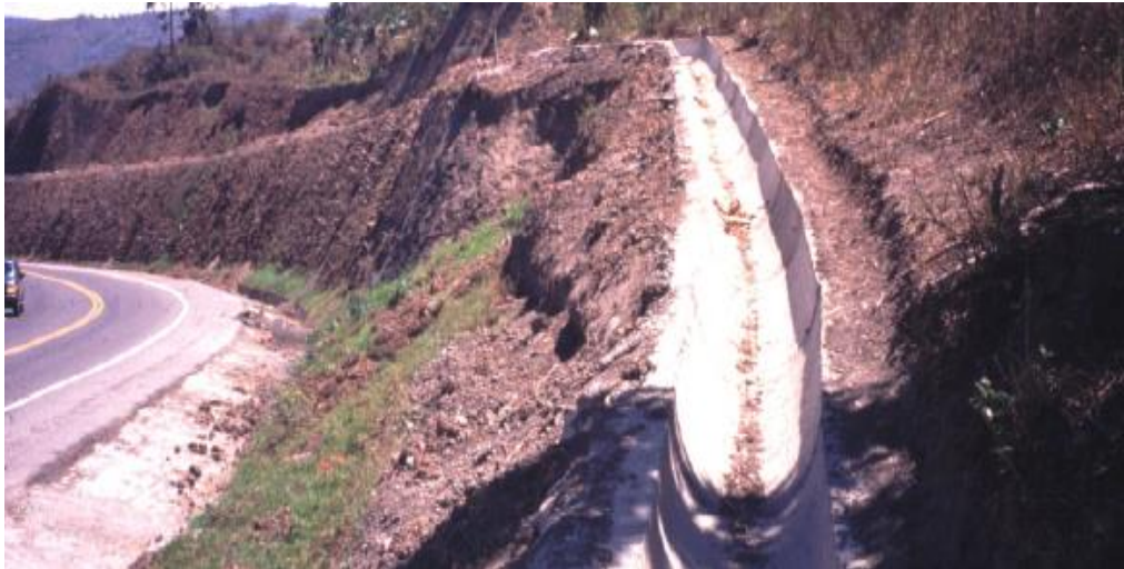
Imagen 27 Construcción inadecuada de una zanja de coronación, por estar muy cercana al borde del talud
