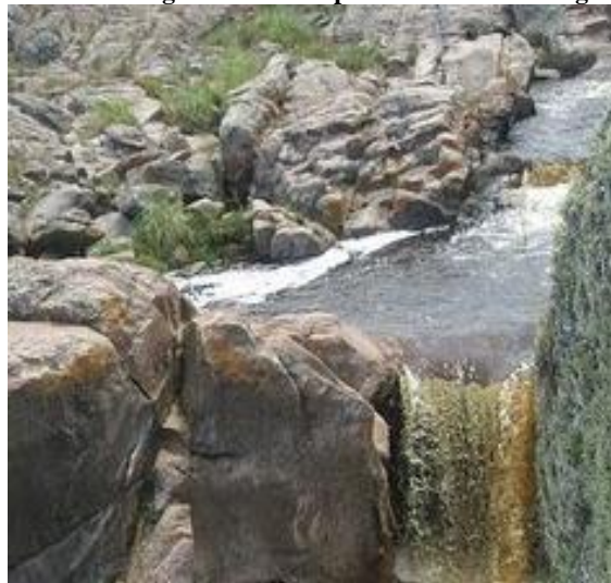
Imagen 15 Erosión por afloramiento de agua
