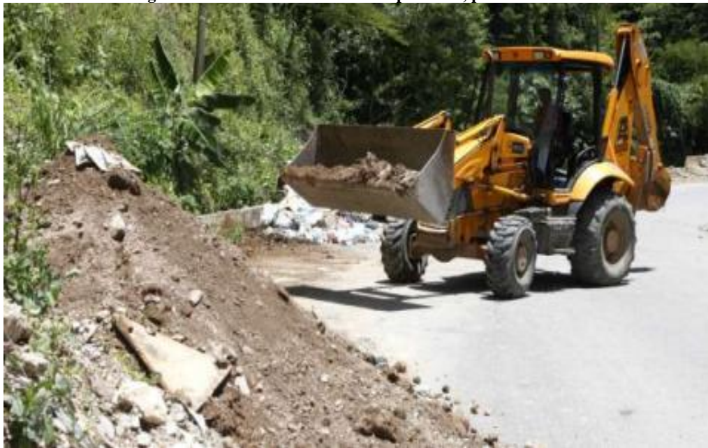
Imagen 18 Acumulación de suelo en depresiones, por deslizamiento
