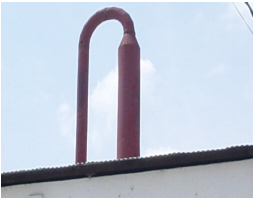
Figura No. 9 Chimenea para salida de vapor
