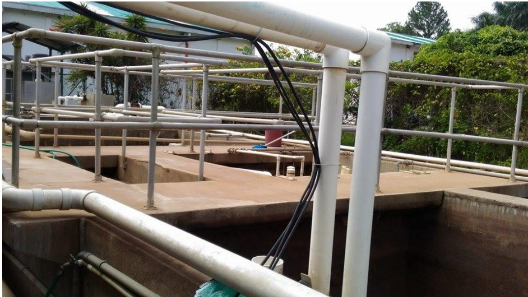
Figura 35 Planta de tratamiento de agua residual
