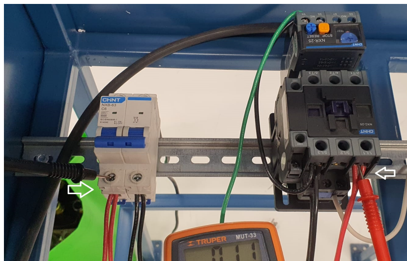
Figura 8: Continuidad entre contactor y flipón
