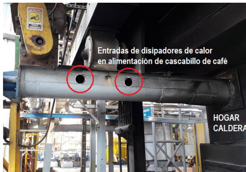
Figura 14: Ubicación de entrada de disipadores de calor en alimentación de combustible
