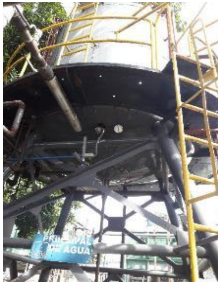
Figura 3: Tanque pulmón de precalentamiento de agua
