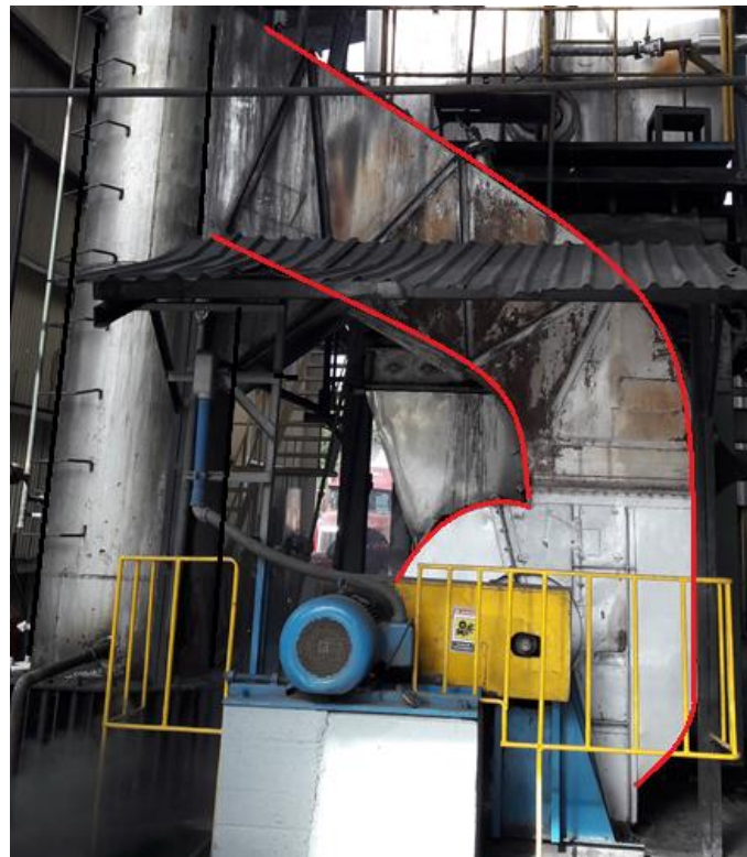
Figura 7: Tiro inducido caldera 1 de biomasa
