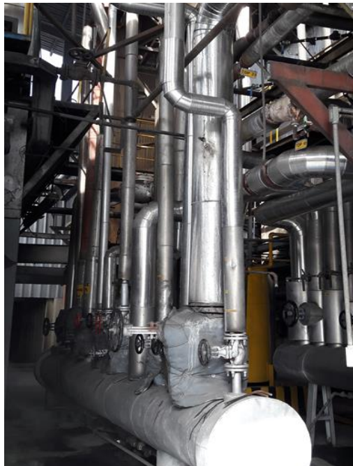
Figura 8: Aislamiento térmico de tuberías de caldera de biomasa
