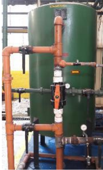
Figura 2: Suavizadores iónicos de agua para caldera 1
