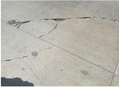
Figura No. 37. Fallas en pavimento rígido.
