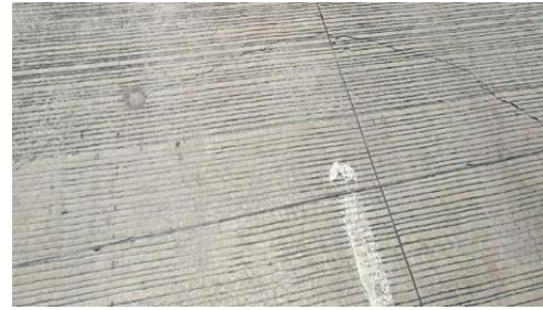
Figura No. 38. Fallas en pavimento rígido.
