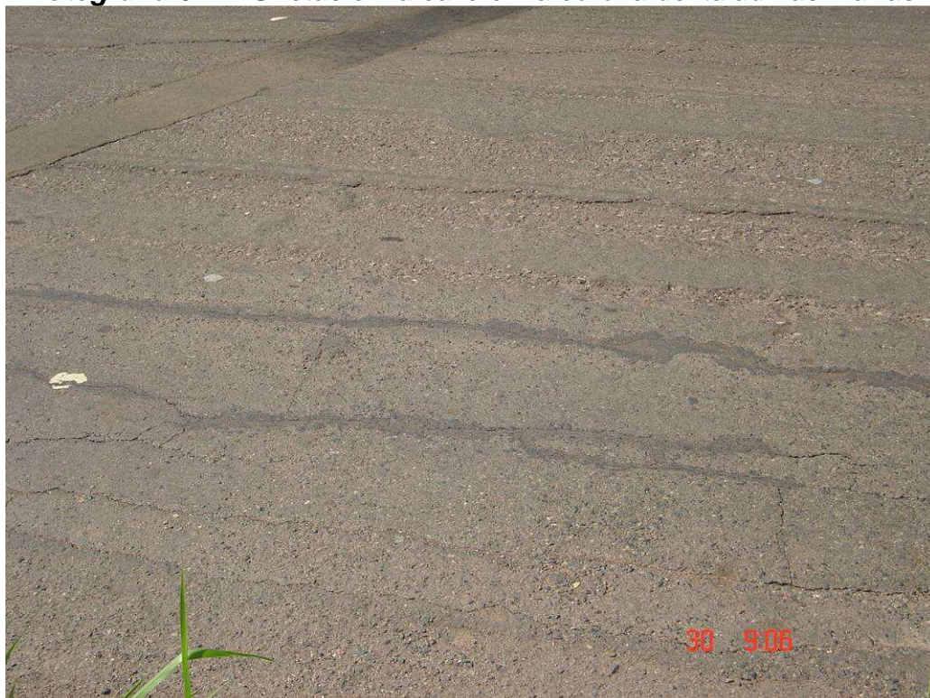
Fotografía 6.2.2 Grietas en la calle en la corona del talud Las Marías
