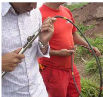
Conexión de la sonda Inclinométrica 4
