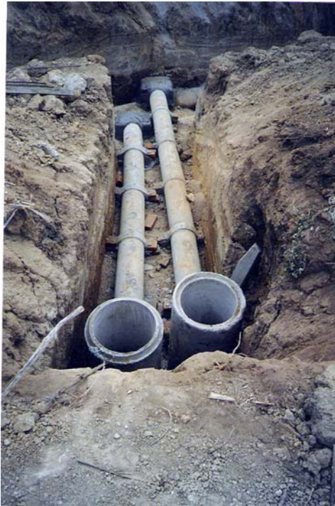
Fotografía # 09 Candelas domiciliarias para drenaje pluvial y sanitario
