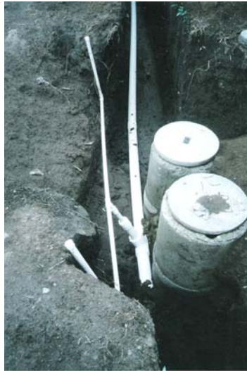
Fotografía # 13 Conexiones domiciliares de agua potable
