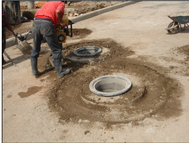
Fotografía # 08 Aros de tapaderas de metal para pozos de visita
