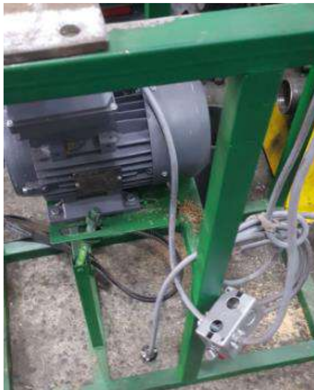
Figura No. 101 Instalación eléctrica motor
