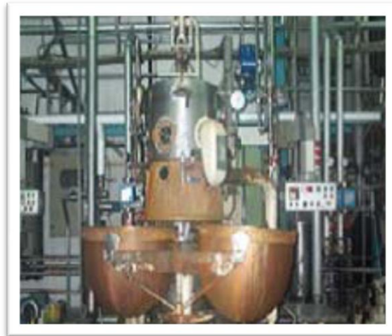
Figura 4. Cámara presurizada y evaporador
