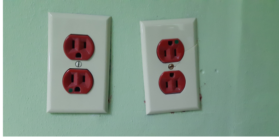
Figura 14: Detección toma corriente deteriorado
