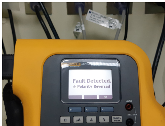
Figura 12: Detección de falla, polaridades invertidas
