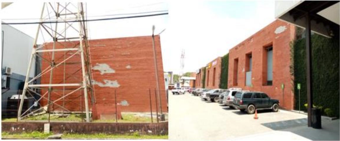
Ilustración 34. Deterioro en la fachada del edificio principal
