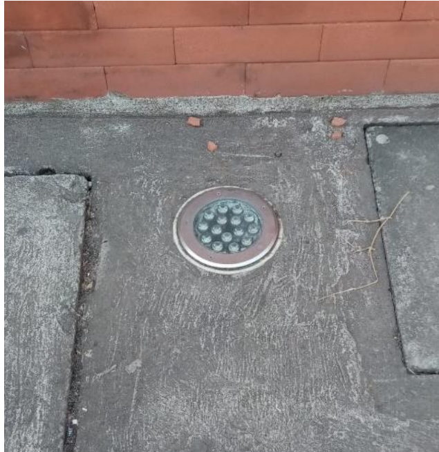
Ilustración 39. Luminaria LED empotrada en el suelo del parqueo
