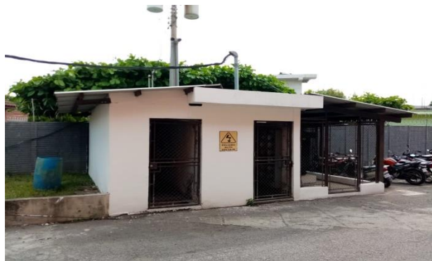
Ilustración 78. Cuarto eléctrico del Centro Comercial
