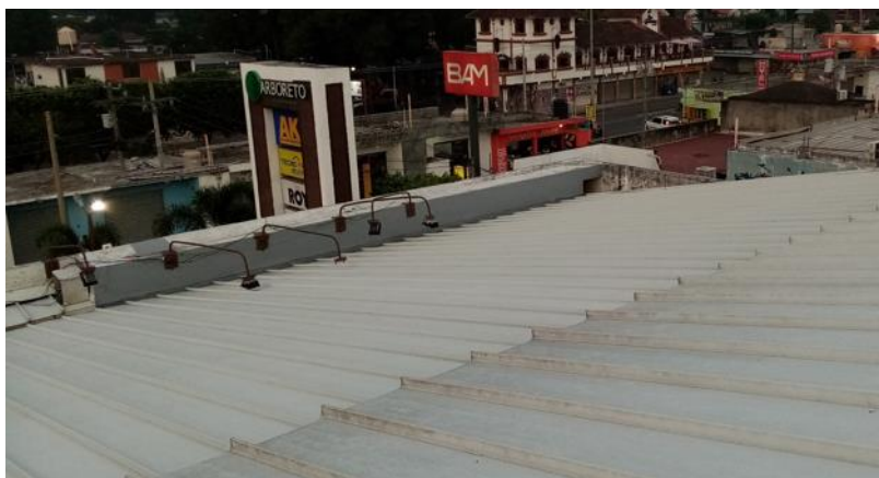
Ilustración 36. Luminarias LED inservibles
