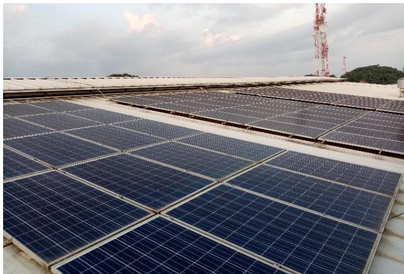
Ilustración 29. Sistema fotovoltaico existente en la cubierta
