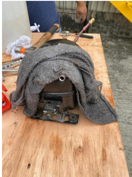
Figura 59. Método de protección del compresor para remover piezas soldadas por el fabricante del equipo
