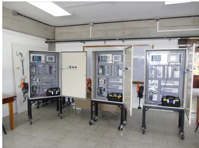
Figura 2: Tableros laboratorio de instrumentación y automatización Industrial
