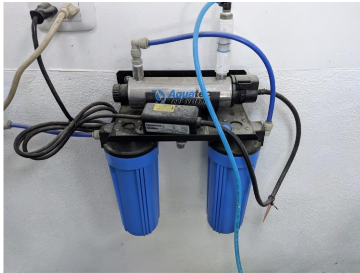
Figura 28: Sistema de filtración de agua con UV
