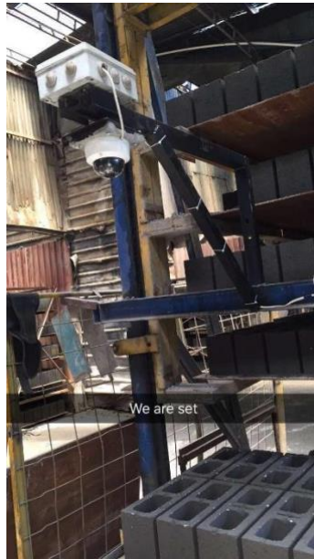
Ilustración 23. Imagen donde muestra instalación de la cámara de red.
