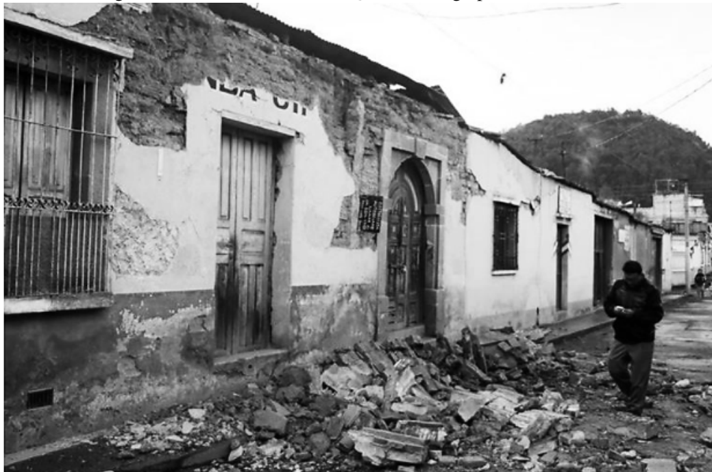
Figura 2: Vivienda afectada en Quetzaltenango por sismo de 2017
