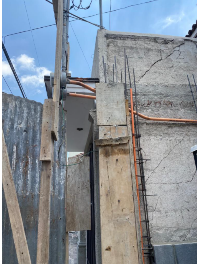
Figura 16. Efectos en el muro
