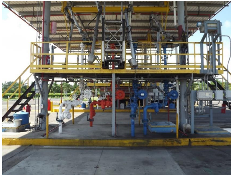
Ilustración 21. Vista lateral de un rack de carga en Planta 2.
